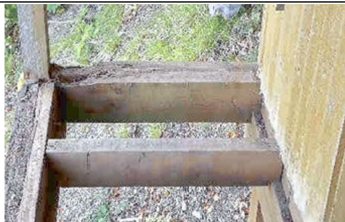
Vor der Reparatur
